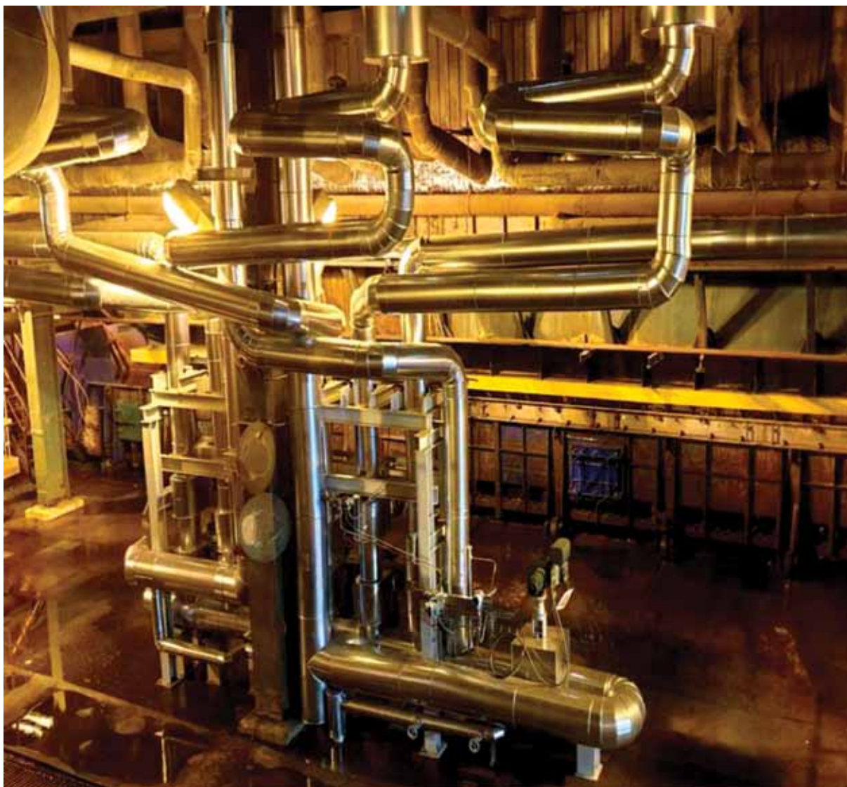
RYS. 1. INSTALACJA GRZANIA WALCZAKA/PAROWNIKA PARĄ Z ZEWNĘTRZNEGO ŹRÓDŁA
