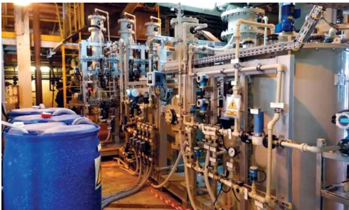
RYS. 8. INSTALACJA PILOTAŻOWA DO REDUKCJI EMISJI BORU W ŚCIEKACH - WIDOK INSTALACJI PO URUCHOMIENIU.
